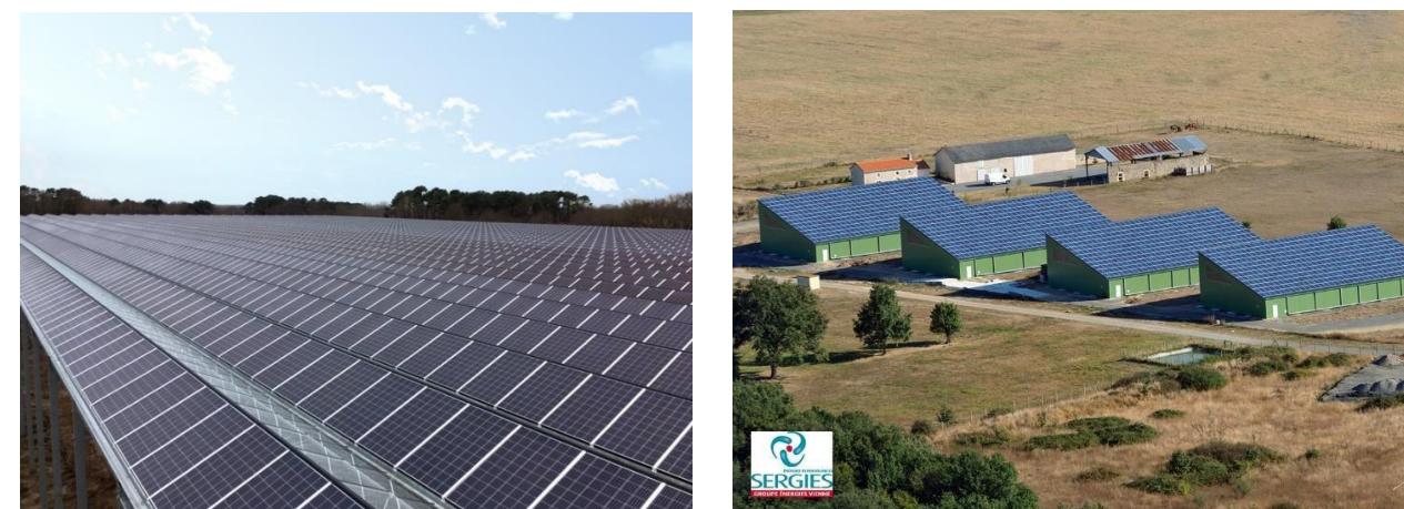
Figure 6 : Serre à gauche (Loire-Atlantique) et panneaux en toiture à droite (Vienne).
